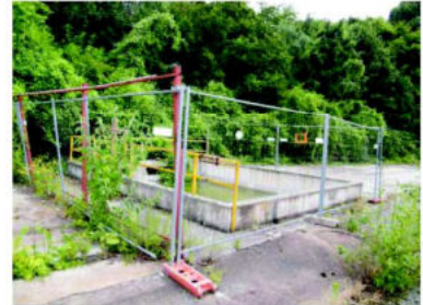
Fosse eaux pluviales
