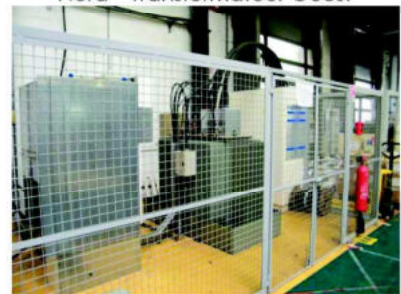
Partie bâtiments industriels – zone Nord – Transformateur dans bâtiment
